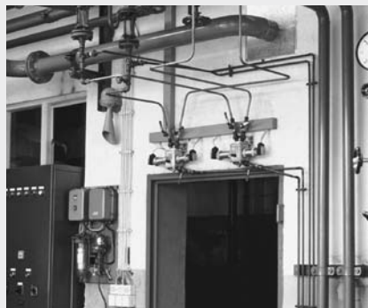
Überwachung auf Fett- und Öleinbruch in zwei getrennten Kondensatrückläufen
